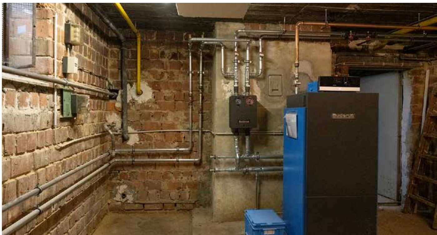
Neue Heizung im alten Keller
